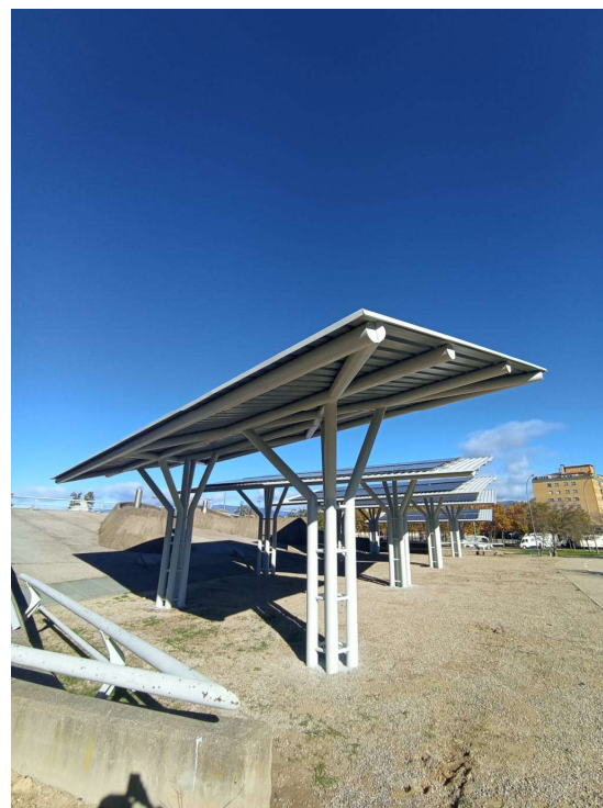
Instalación solar fotovoltaica
