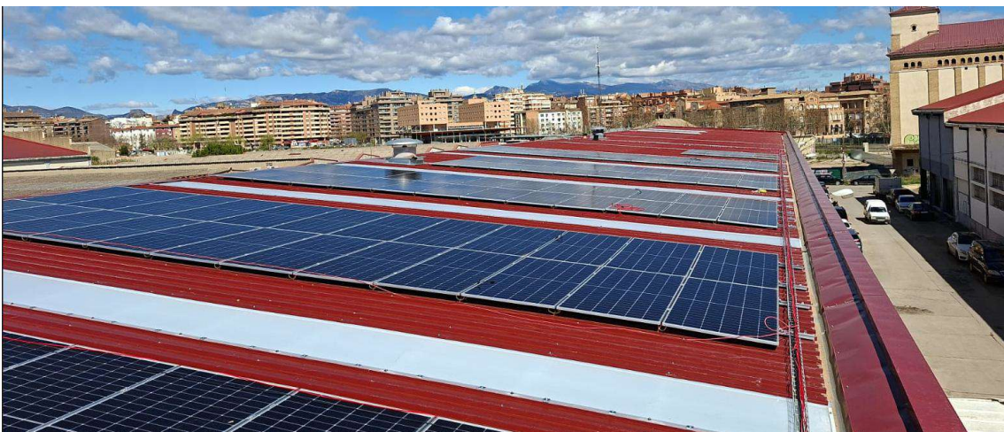
Instalación solar fotovoltaica
