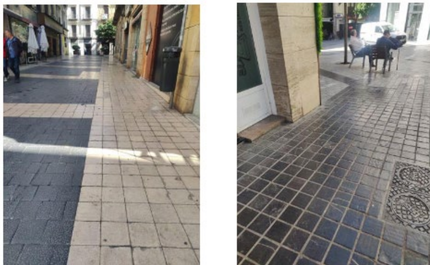
Ilustración 38. Pavimentos deslizantes cerca de la Basílica de San Lorenzo en Huesca
