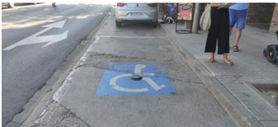
Ilustración 40. Problemas de accesibilidad en una plaza de PMR en la C. Obispo Pintado
